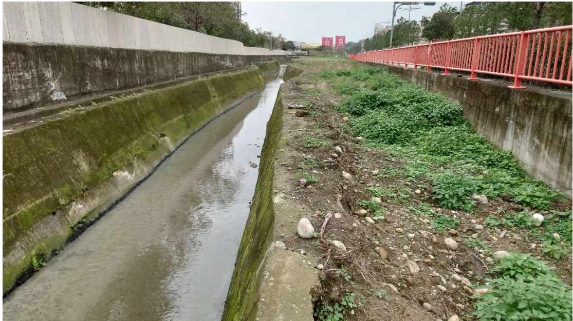
圖 13、調查範圍隆恩圳西段一景，堤岸較舊且部分有崩塌的現象。
